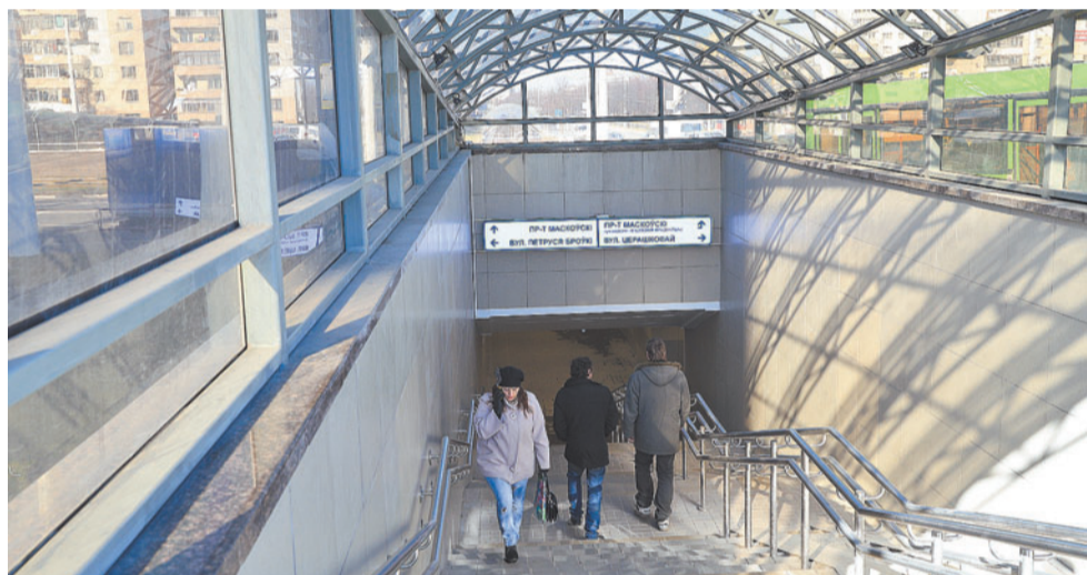
Качественно и в срок выполнили работники ООО «ПлиссаСтрой» реконструкцию подземного перехода на пересечении Московского проспекта и улицы Петруса Бровки: сегодня здесь приятно пройти.
